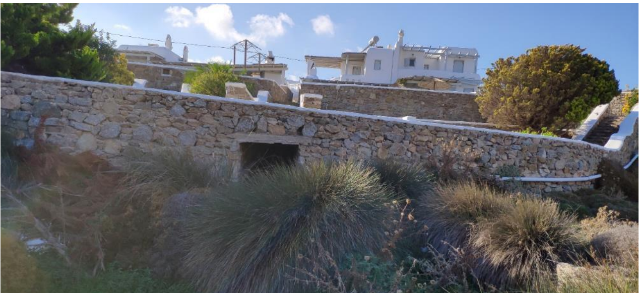
Εικόνα 16: Οχετός εξόδου δυτικού κλάδου ρέματος Καλαφάτη
