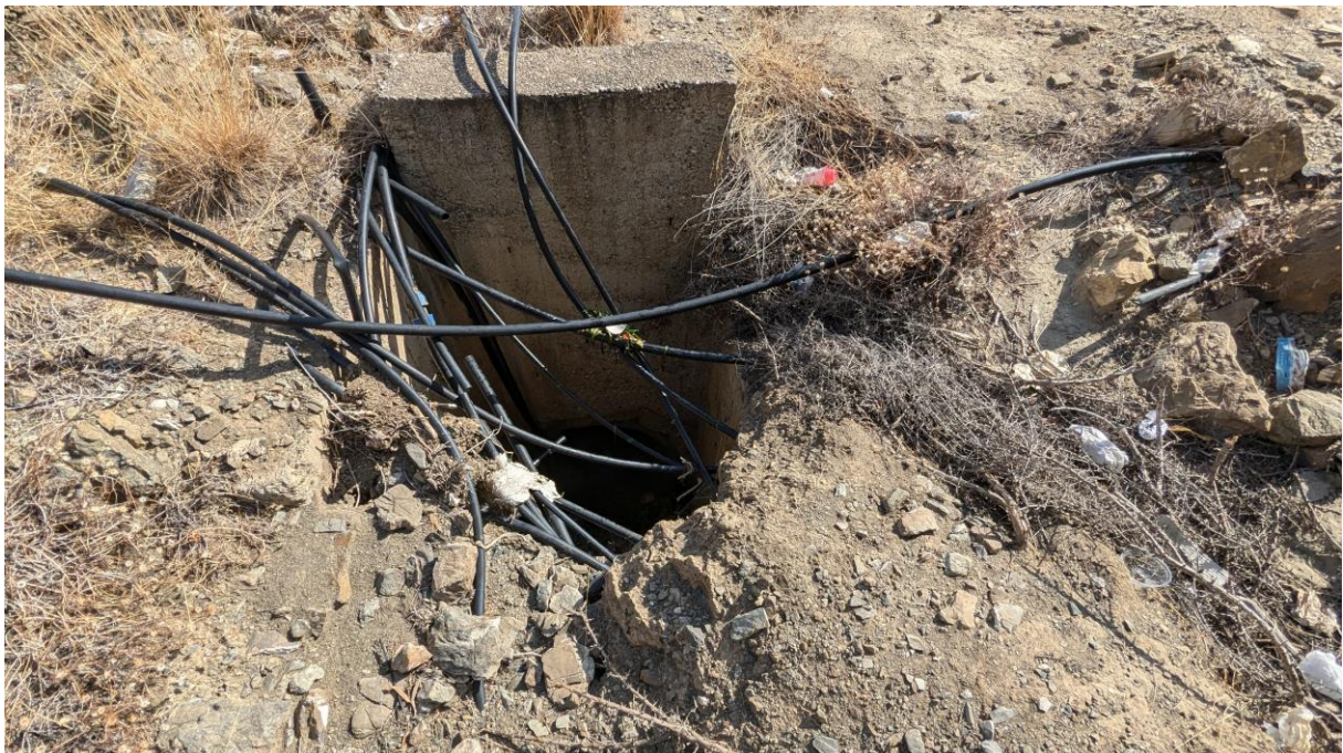
Φωτογραφία 8 Φρεάτιο πτώσης στη συμβολή των κλάδων του ρέματος ανάντη της δημοτικής οδού. Λήψη προς Ν
