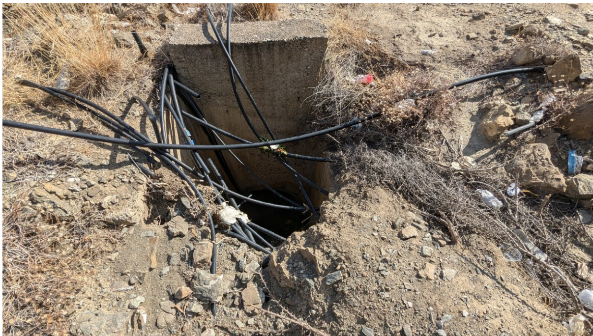
Εικόνα 3-6 Φρεάτιο πτώσης στη συμβολή των κλάδων ανάντη της δημοτικής οδού
