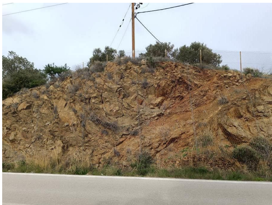
Φωτογραφία 24: Εμφάνιση ψαμμιτικού φλύσχη με χαρακτηριστική ζώνη διάρρηξης, επί της Επ. Οδού περί τη χ.θ. 17+160, διακρίνεται η τοποθέτηση μεταλλικού πλέγματος.
