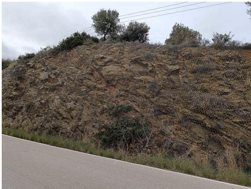
Φωτογραφία 23: Εμφάνιση ψαμμιτικού φλύσχη επί της Επ. Οδού στη χ.θ. 17+160, διακρίνεται η τοποθέτηση μεταλλικού πλέγματος για προστασία από καταπτώσεις.
