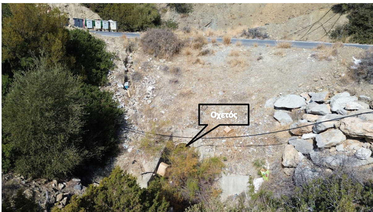
Εικόνα 2-12. Διέλευση του ρέματος κάτω από τον επαρχιακό δρόμο μέσω οχετού.
