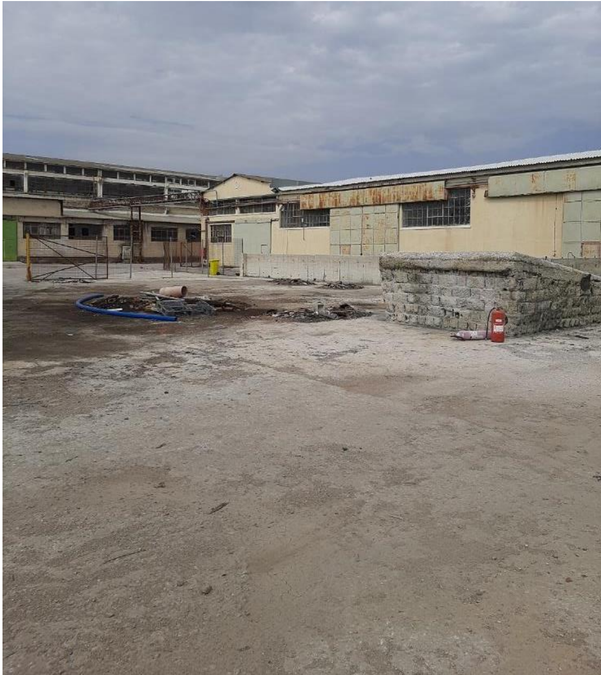
Φωτογραφία 8: Υπολείμματα ουσιών στον πρώην χώρο αποθήκευσης επικίνδυνων αποβλήτων του πρώην εργοστασίου της ΧΑΛΚΟΡ (Κτίρια 12 και 17)
