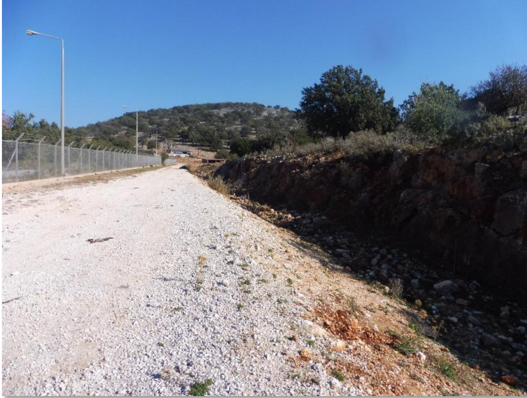
Φωτ.2.6. Η ανοικτή χωμάτινη τάφρος εκτροπής του υδατορέματος 3B, κοντά στη θέση όπου το υδατόρεμα εισέρχεται σε μη προσβάσιμο τεχνικό έργο.
