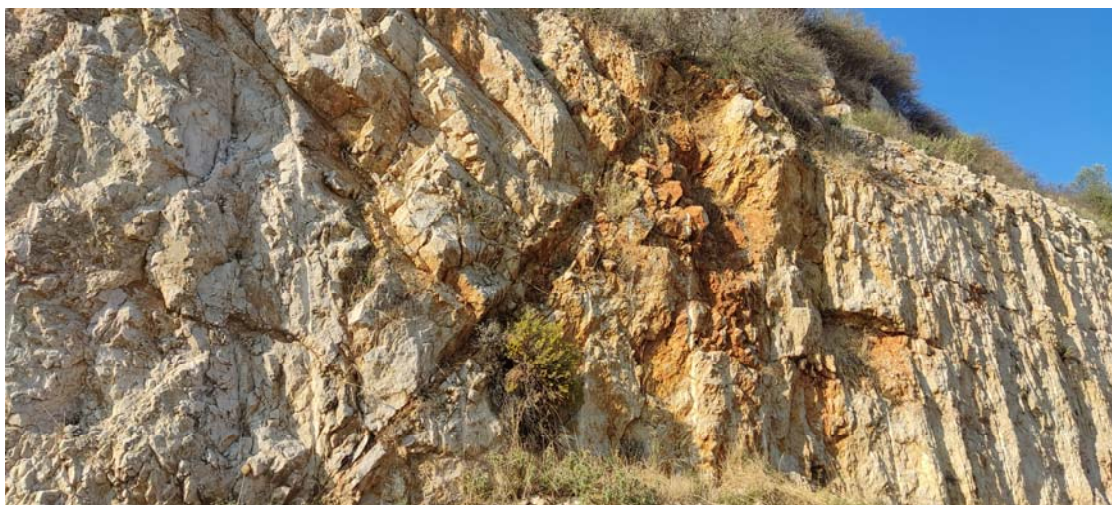
Φ22.. Άποψη ασβεστολιθικών πρανών δυτικής περιμετρικής οδού. Ζώνη ρήγματος που συνοδεύεται από έντονη μεταβολή του προσανατολισμού της στρώσης
